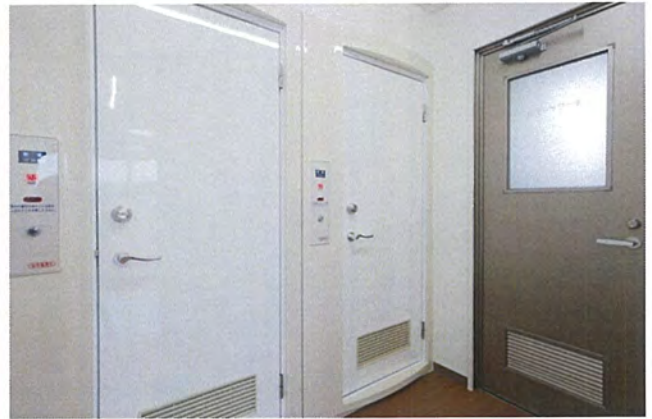
休憩棟 コインシャワー
