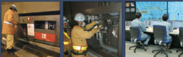
泡消火栓点検
